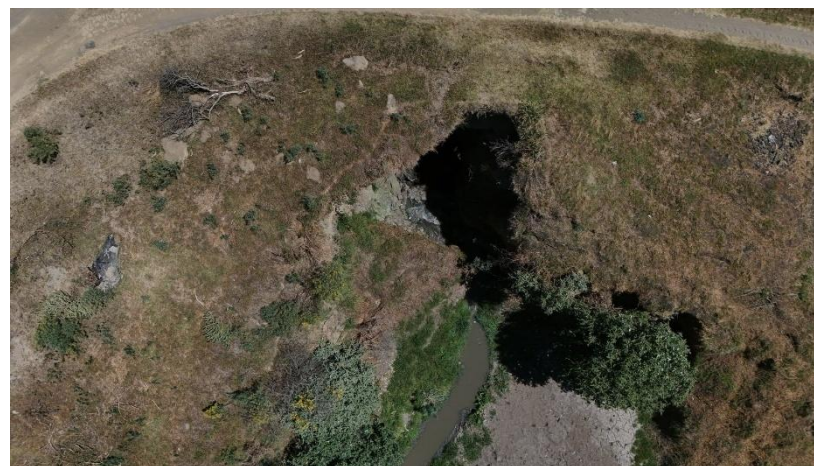
FR-02 GRIETA DE DRENAJE URBANO (IMAGEN 140) Fuente: Coordinación de Protección Civil y Bomberos 2025
