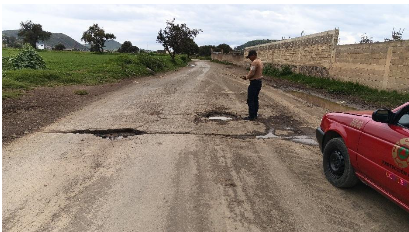
FR-04 GRIETA SIBRE CIANTA ASFALTICA VIA DE COMUNICACIÓN CAMINO CUECUEUAUTITLA (IMAGEN 138) Fuente: Coordinación de Protección Civil y Bomberos 2025
