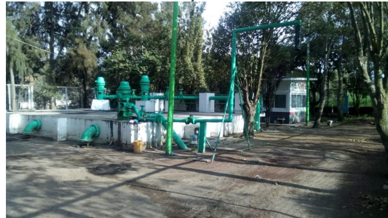
PLANTA DE REBOMBEO 4 ABASTECEDORA DE AGUA. (IMAGEN 24) Fuente: Coordinación de Protección Civil y Bomberos
