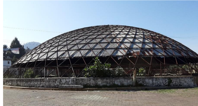
ALJIBE EN DESUSO SIN SANEAMIENTO (IMAGEN 23) Fuente: Coordinación de Protección Civil y Bomberos
