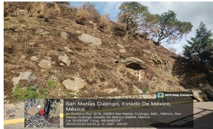
AREA DE ALTO RIESGO POR DESLIZAMIENTO DE TIERRA Y PIEDRAS DE DIFERENTES DIMENSIONES TENIENDO ANTECEDENTES EL EL AÑO 2023 CAIDA DE ROCA CON AFECTACION A SAGUAN DE UN DOMICILIO CALLE LERDO COLINDANTE CON MERCADO CUIJINGO, SIN PERDIDA DE VIDAS SOLO DAÑOS MATERIALES. (IMAGEN 133) Fuente: Coordinación de Protección Civil y Bomberos 2025
