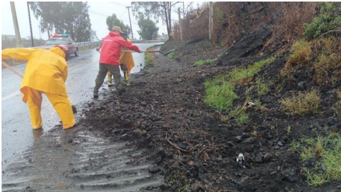
DELIZAMIENTO DE TIERRA Y PIEDRAS POR AFECTACION PLUVIAL 2025 (IMAGEN 130) Fuente: Coordinación de Protección Civil y Bomberos 2025
