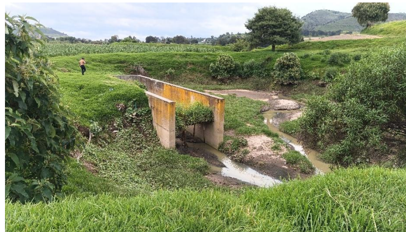
FR-02 DRENAJE URBANO (IMAGEN 139) Fuente: Coordinación de Protección Civil y Bomberos 2025
