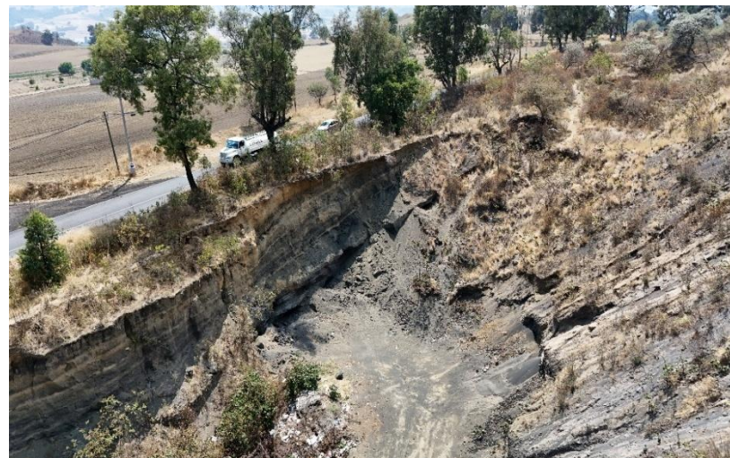
(IMAGEN 162) Fuente: Coordinación de Protección Civil y Bomberos 2025. EXTRACCION DE ARENA NEGRA CON RIESGO HACIA LAS VIAS DE COMUNICACIÓN, TRAMO CARRETERO PRINCIPAL QUE FUNGE COMO RUTA DE ACCESO ANTE CONTINGENCIA VOLCANICA Y ACTIVACION DE PLANES DE EVACUACION, ACTIVIDAD REPORTADA ANTE AREAS CORRESPONDIENTES Y DELEGACION CUIJINGO, HECIENDOLES SOLICITUD DE ASIGNACION ESPECIFICA DE EXTRACCION Y CONTROL DE ACCESO HACIA AREAS DE MINA EN CIELO ABIERTO LAS CUALES SE ENCUENTRAN REGISRTADAS EN ATLAS DE RIESGOMUNICIPAL 2021. 2024. REFERIDA EN MAPA FR. 05
