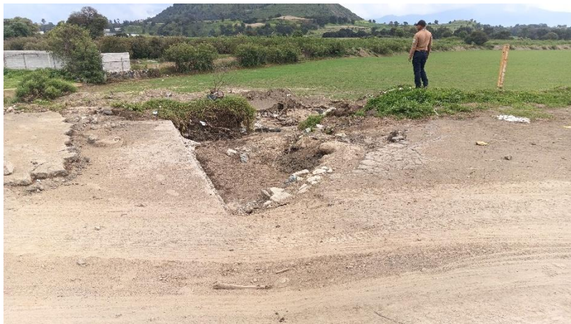
FR-03 GRIETA SIBRE CIANTA ASFALTICA VIA DE COMUNICACIÓN CAMINO CUECUEUAUTITLA (IMAGEN 137) Fuente: Coordinación de Protección Civil y Bomberos 2025
